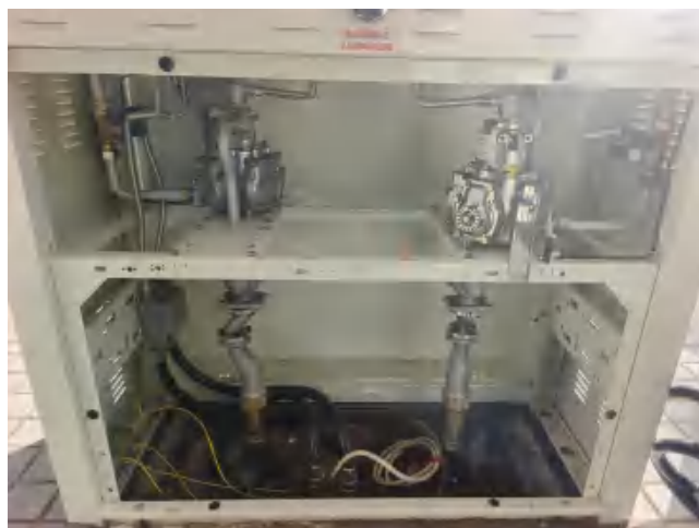
图 6 柴油加油机内部
