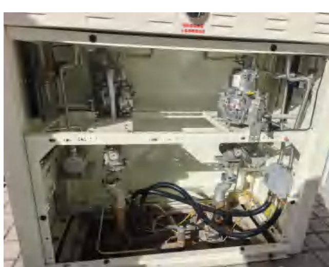
图 8 92#汽油加油机内部
