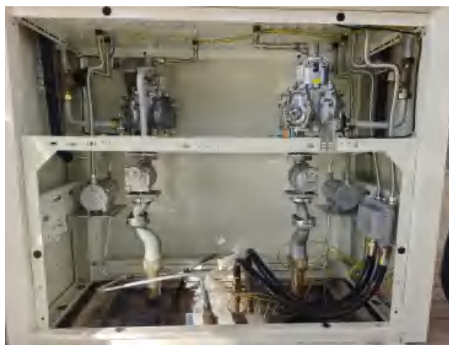
图 10 95#汽油加油机内部
